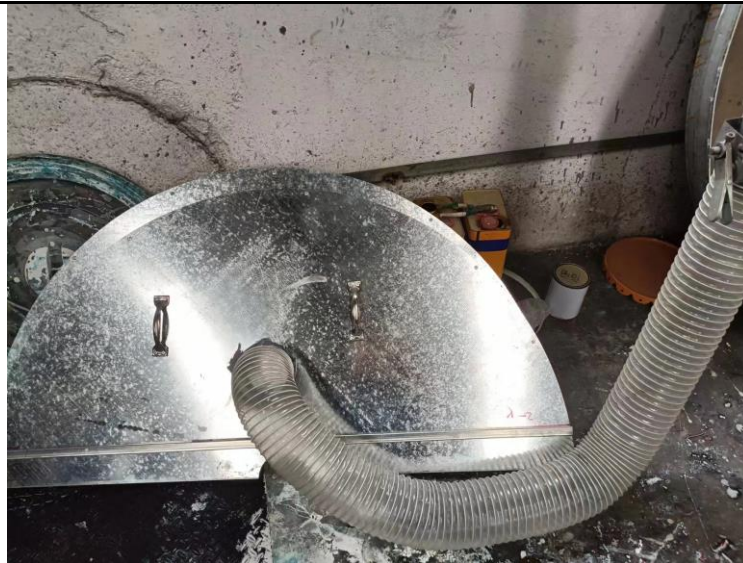
图4-1 分散机收集措施
