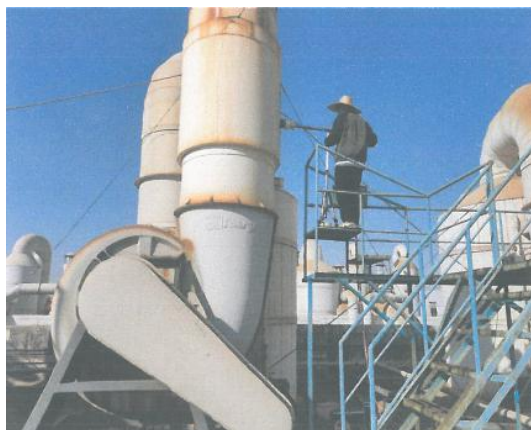
图2-13 原有项目废气治理设施照片
