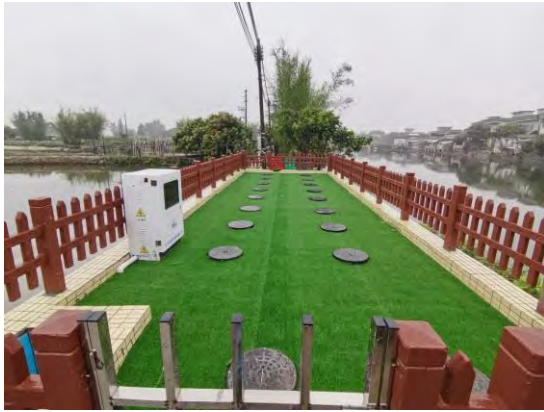
东凌村污水处理站点
