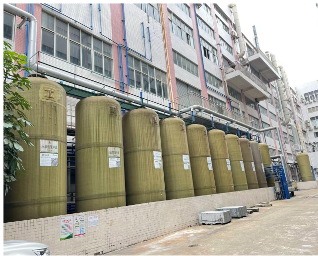
废水罐及 U 型围堰
