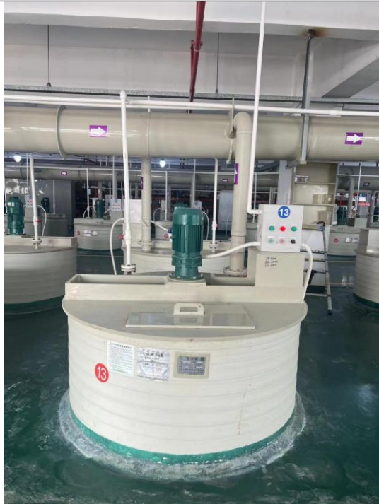
PPH 搅拌器废气收集措施
