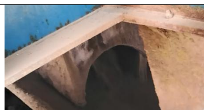
磨砂设备出料口内部洒水
