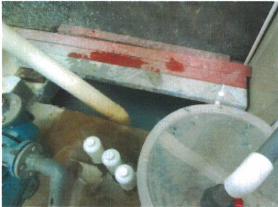
图 5-1 W1 生产废水集水池 (E 112°50'51.01", N 22°30'39.94") 生产废水现场采样照片
