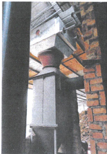
图11 锅炉废气处理设施: 多管除尘
