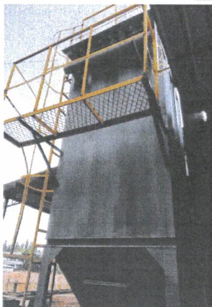
图12 锅炉废气处理设施: 布袋除尘
