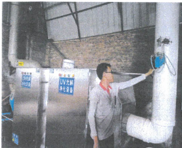
图3 车间废气排气筒采样口 (处理前)
