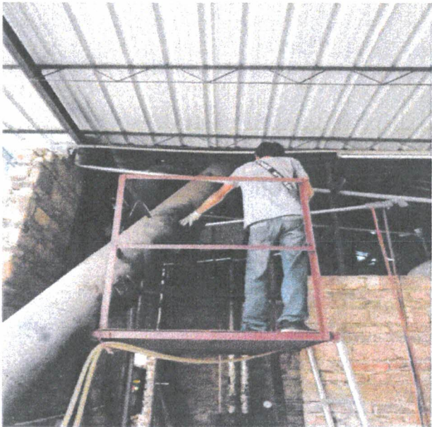
图 2 锅炉废气排气筒采样口 (处理后)
