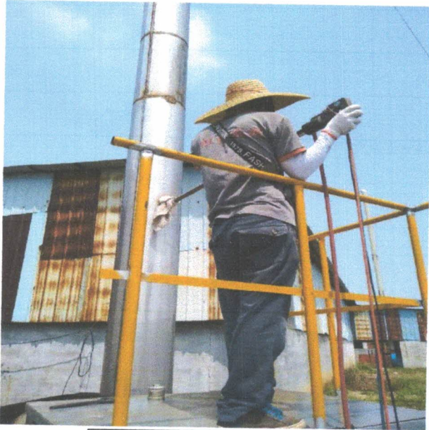
图 2 锅炉废气烟囱采样口 (处理后)
