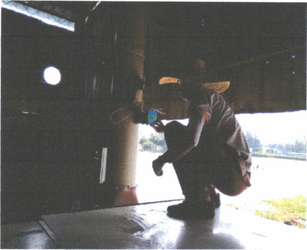
图 4 生产废气排气筒采样口 (处理后)
