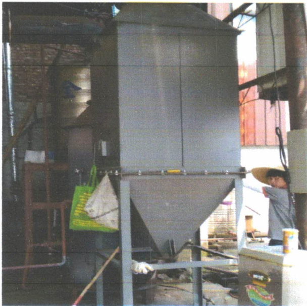
图 11 锅炉废气处理设施: 布袋除尘
