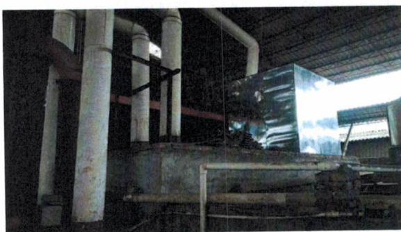
电热炉废气处理设施
