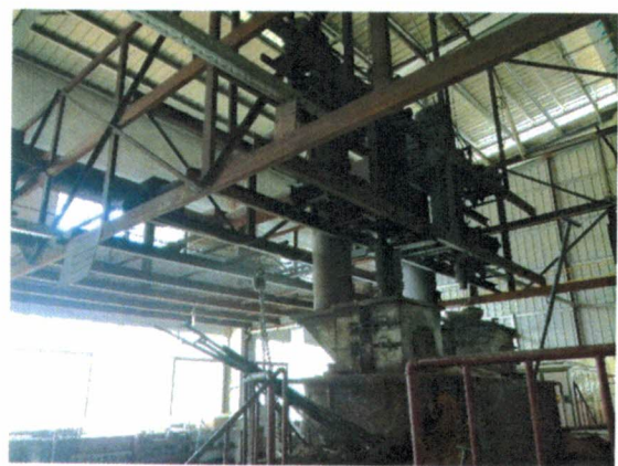
废气收集系统
