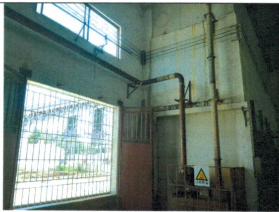
废气收集管道
