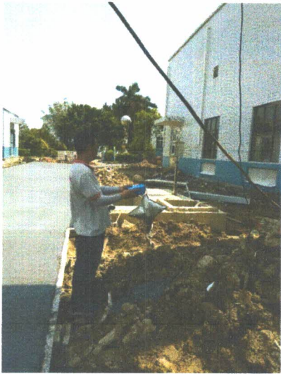
图 17 甲烷监测下风向○4
