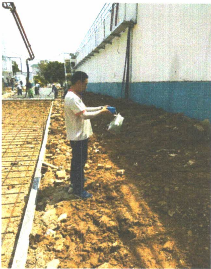
图 16 甲烷监测下风向○3
