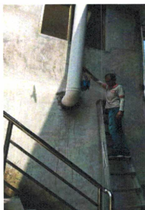
图 1 羽化室废气排气筒采样口 (处理前)
