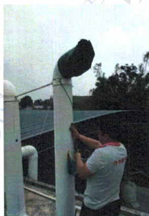
图 2 羽化室废气排气筒采样口 (处理后)
