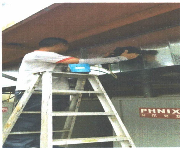
图 4 2#车间废气排气筒采样口 (处理前)
