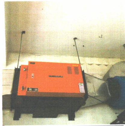
图 21 油烟废气处理设施: 静电除油
