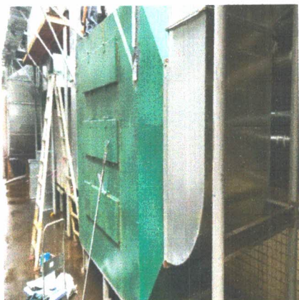
图 19 2#车间废气处理设施: 活性炭吸附
