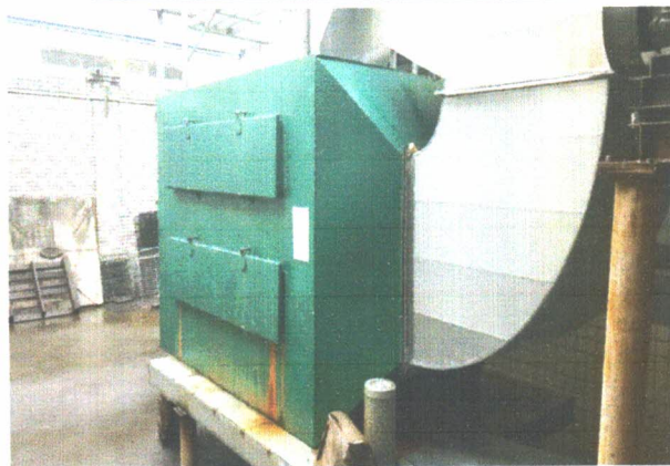
图 18 1#车间废气处理设施: 活性炭吸附
